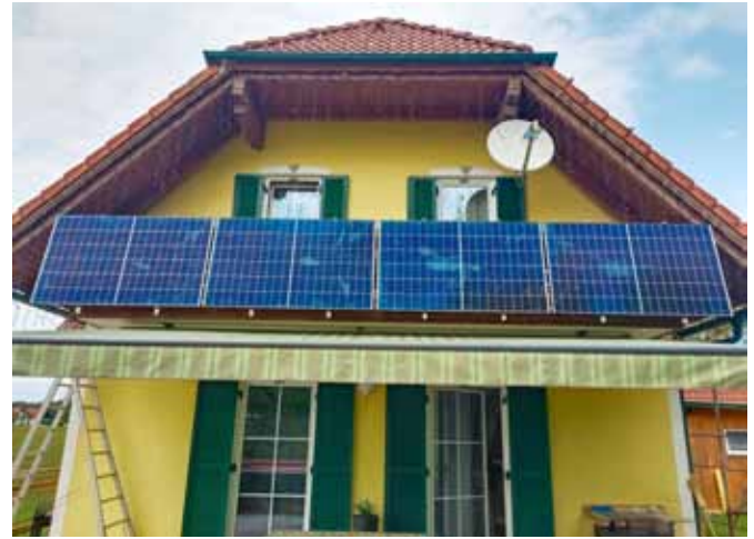
... und neuerdings auch an Balkonfronten montiert werden.
