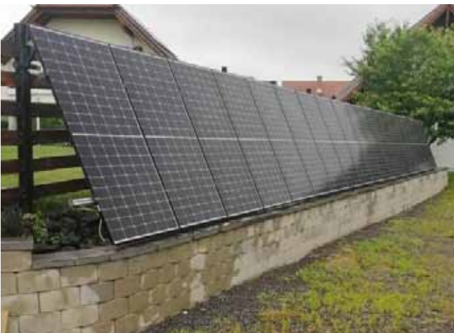
Auch Zäune eignen sich als Montageträger für PV-Anlagen.
